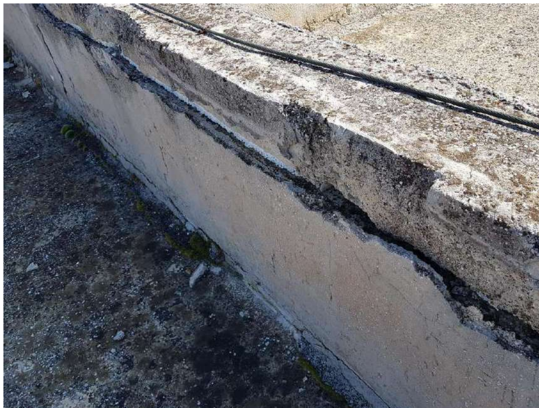
Καταστροφή μόνωσης των ανεστραμμένων δοκών της πλάκας του ορόφου
